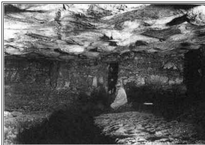
Vista del techo de la <<Sala de las pinturas>>, tomada mirando a la puerta de entrada y al muro de contención.
